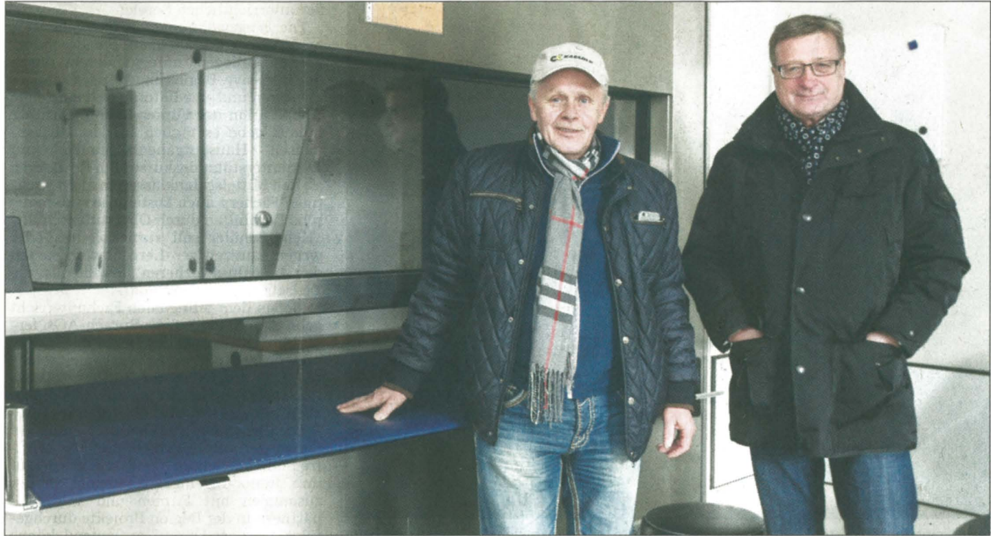
Beheizbare Patientenschleuse vom OP in den Aufwachraum: Fürs neue Klinikum hätte sich der Ausbau nicht gelohnt, aber zum Wegwerfen ist die Einrichtung zu schade. Der Ausbau ist kompliziert. Aber MVG-Chef Herbert Bollmann (links) und Dechow-Gutachter Volker Büttner schreckt dies nicht ab.
